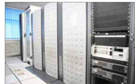
高速铁路宽带移动通信 (LTE-R) 平台
